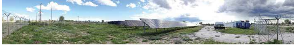
Photovoltaik-Anlage in Gam, einem Ort in der Region Otjozondjupa im Nordosten von Namibia. Foto: Fabian Junker, TH Ingolstadt
